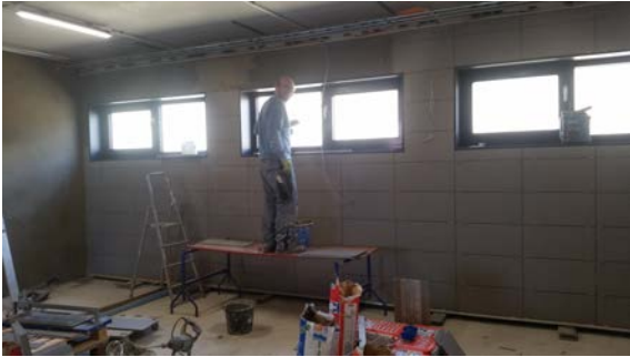
Der Fliesenleger bei der Arbeit in der späteren Schlauchwaschanlage, ein Großteil ist schon fertig...die wurde bereits bestellt wird aber erst im Sommer geliefert
