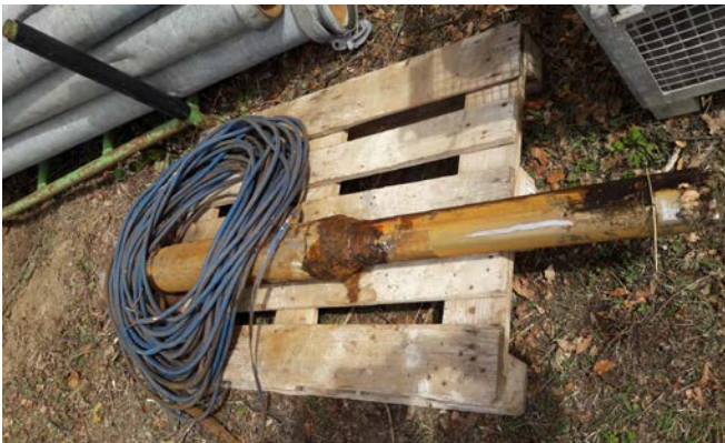
Verockerte ausgebaute Brunnenpumpe
