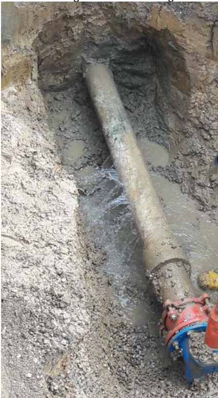
Bild eines Wasserrohrbruches einer veralteten Leitung
