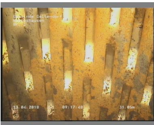
In diesem Beispiel in der Mitte des Brunnens auf 31 m Tiefe sind die Filterschlitzte noch weitgehend frei in einem kleinen Bereich
